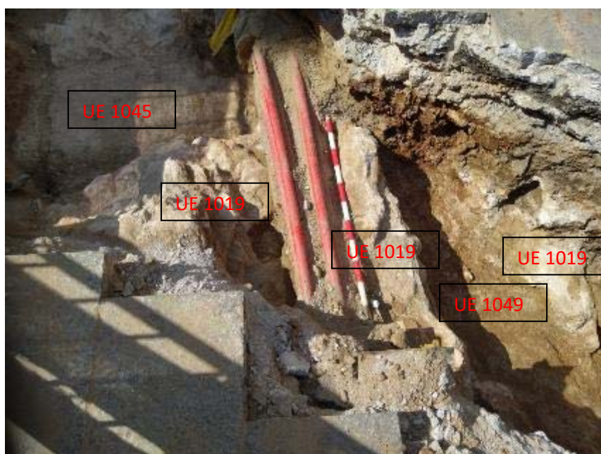
Fig.39-Vista de la rasa de connexió entre el carrer dels Arcs i la Plaça Nova.
