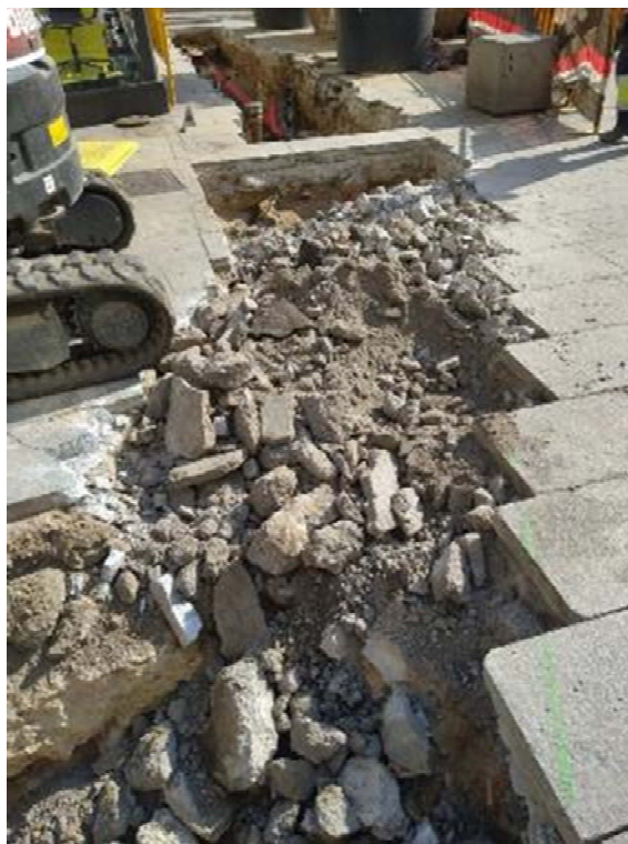
Fig.28- Fotografia dels treballs executats en l'obertura del tram de rasa comprès entre la part sud del carrer dels Arcs i la plaça Nova.
