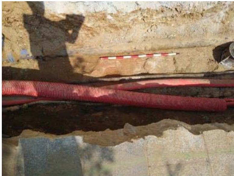
Fig.55- UE 1050. S'observen els cables elèctrics que passaven per sobre.
