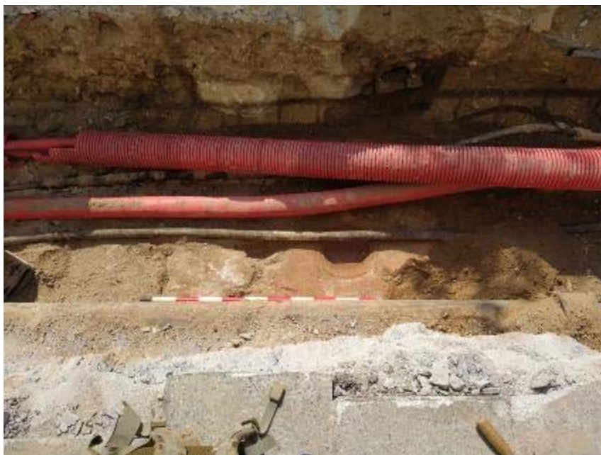
Fig.56- UE 1050. S'observen els cables elèctrics que passaven per sobre.
