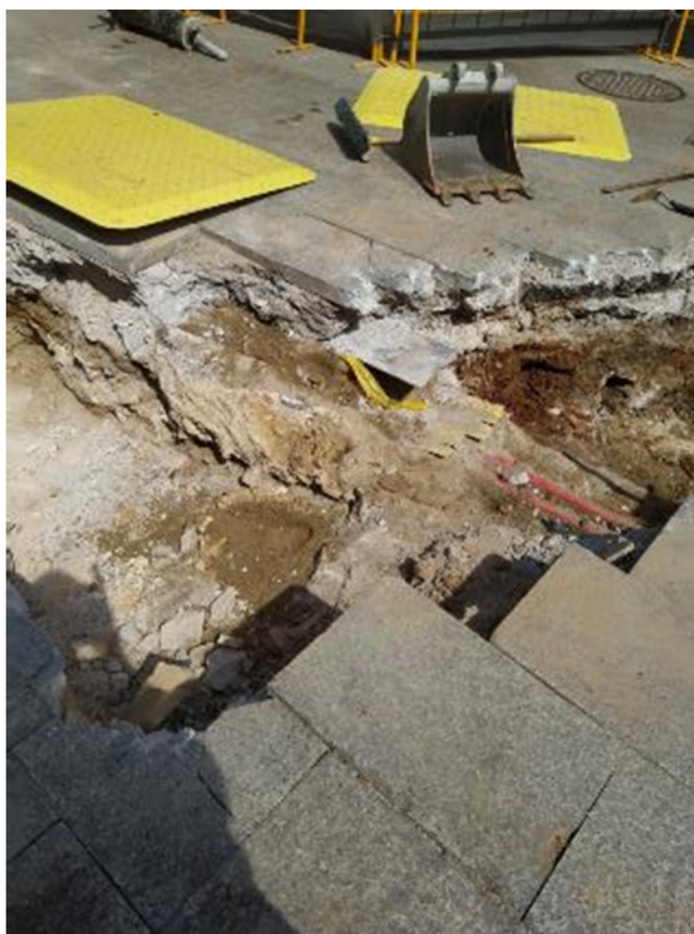
Fig.30- Cable d'alta tensió aparegut en relació a la UE 1019 i al tram de rasa anterior.
